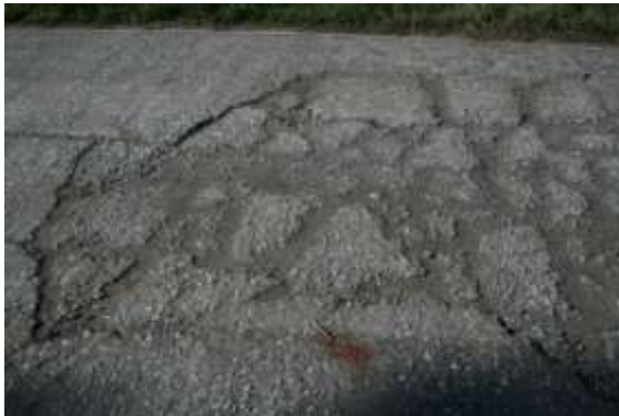
Εικόνα 5. Αστοχία οδοστρώματος του τμήματος Π-3
